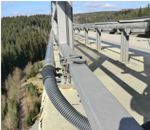
Abbildung 14: Kabelführung an Brücken (Bestand, Beispiel 5)
