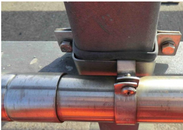
Abbildung 11: Kabelführung an Brücken (Bestand, Beispiel 2)
