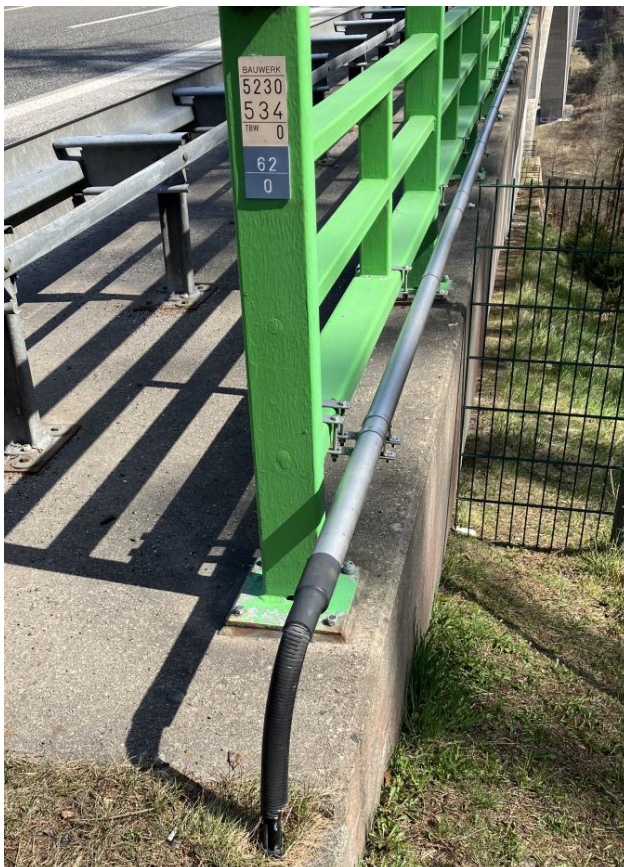
Abbildung 15: Kabelführung an Brücken (Bestand, Beispiel 6)
