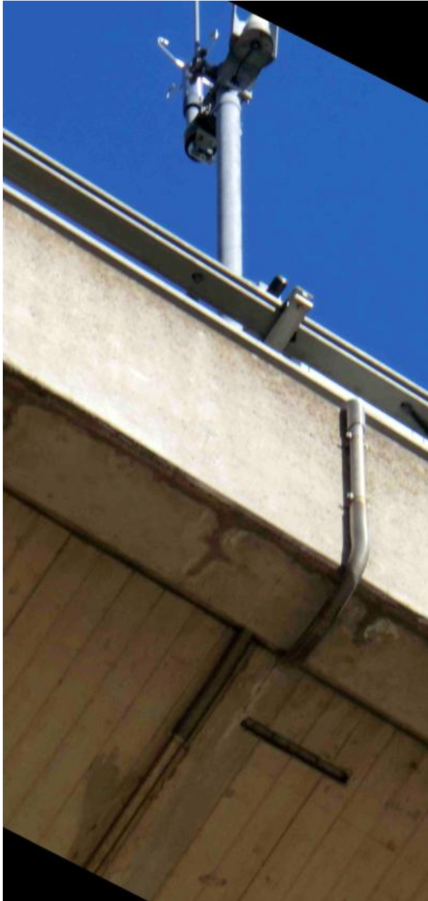
Abbildung 13: Kabelführung an Brücken (Bestand, Beispiel 4)
