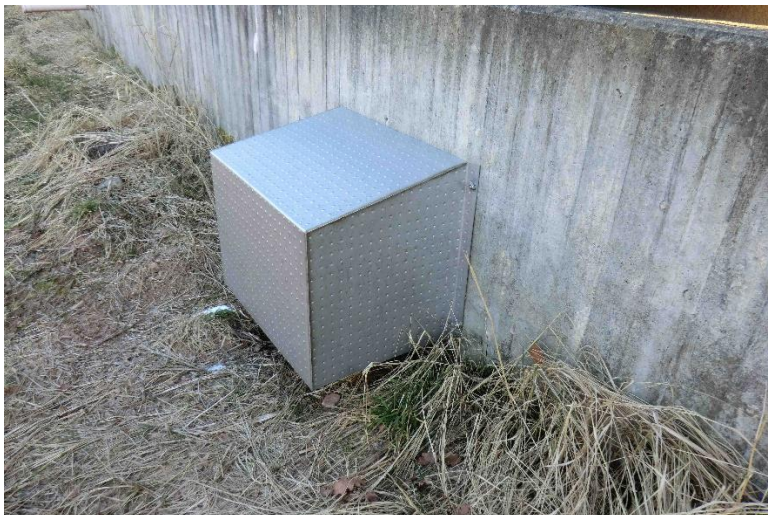
Abbildung 2: Standort 2 Außenbereich - Kabeleinführung
