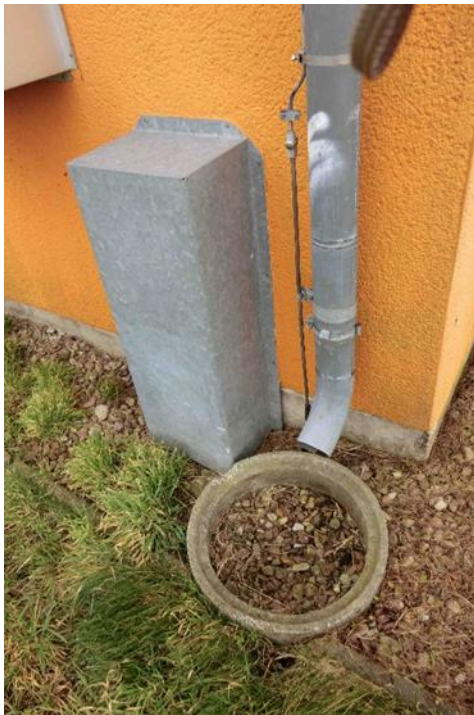
Abbildung 1: Standort 1 Außenbereich - Kabeleinführung
