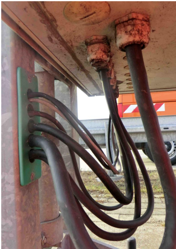
Abbildung 9: Kabeleinführungen am Mastgehäuse (Bestand, Beispiel 2)
