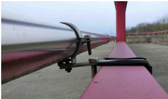
Abbildung 10: Kabelführung an Brücken (Bestand, Beispiel 1)
